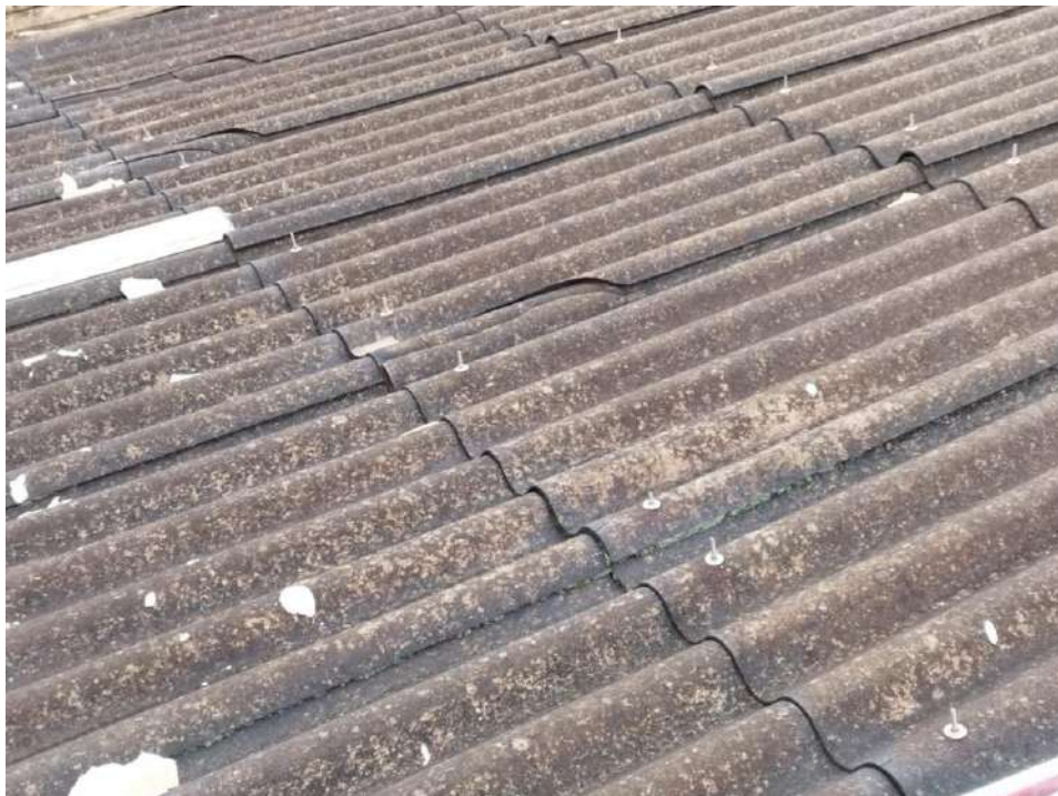
Figura 14 – Destaque para o telhado do plenário com as telhas quebradas e trincadas.
