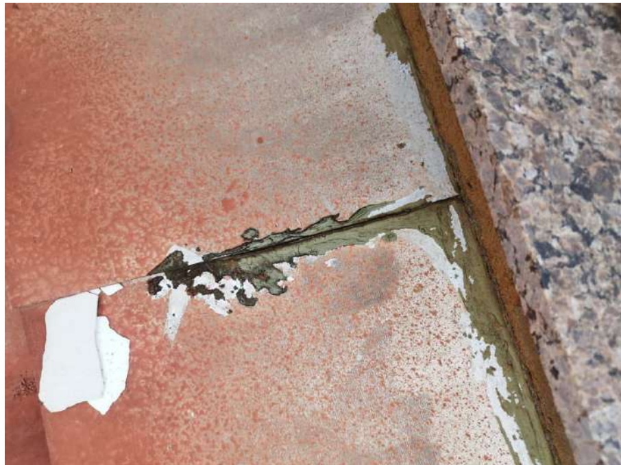
Figura 23 – Destaque para o rufo do telhado do pavimento superior soltando da parede e amassado na emenda.
