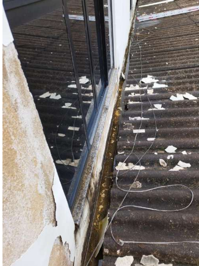
Figura 13 – Destaque para o telhado do plenário com as telhas quebradas e trincadas, além de calhas em estágio final de utilização. Paredes soltando a pintura.
