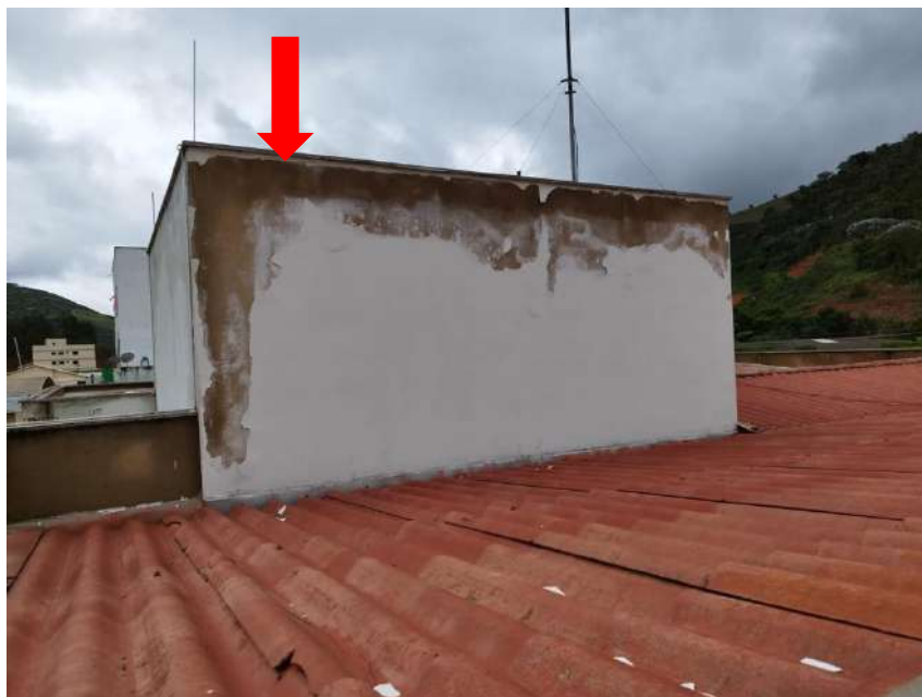
Figura 07 – Destaque para as paredes do reservatório elevado soltando a camada de proteção (pintura)
