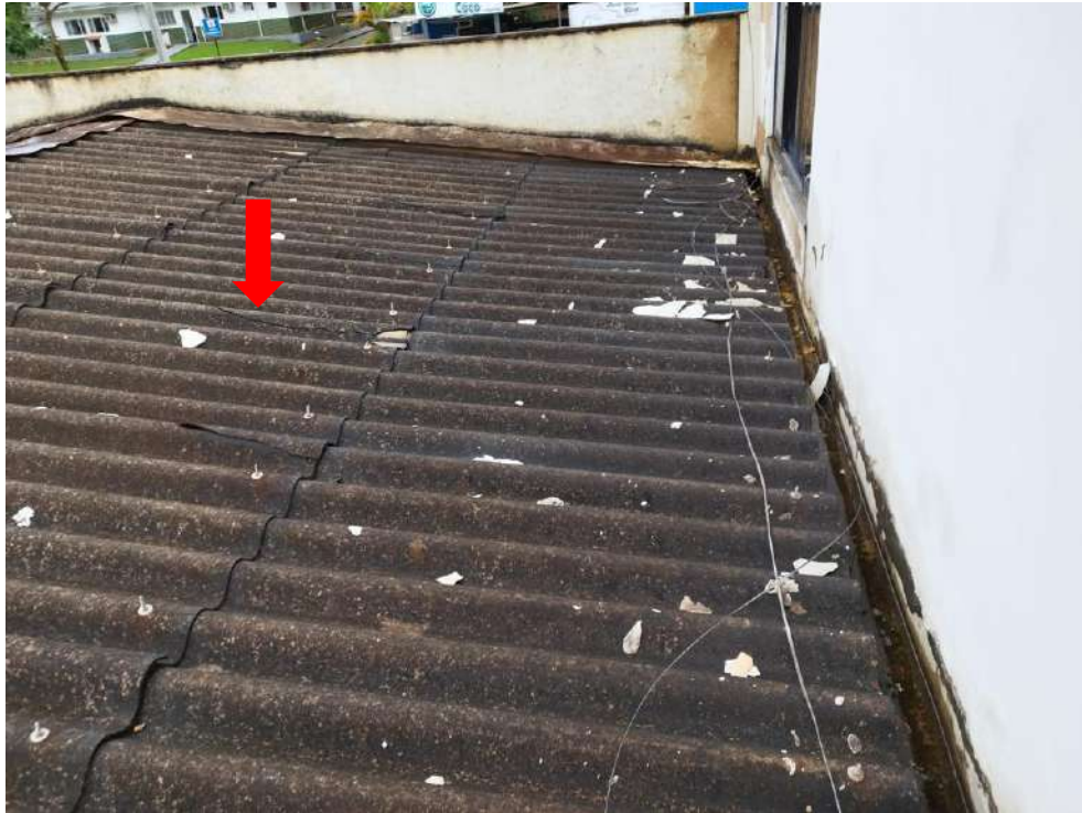
Figura 11 – Destaque para o telhado do plenário com as telhas quebradas e trincadas, além de calhas e rufos em estágio final de utilização, causando patologias a edificação.
