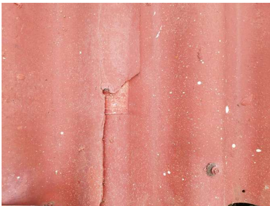
Figura 29 – Destaque para telhado do pavimento superior com telhas quebradas e remendadas.
