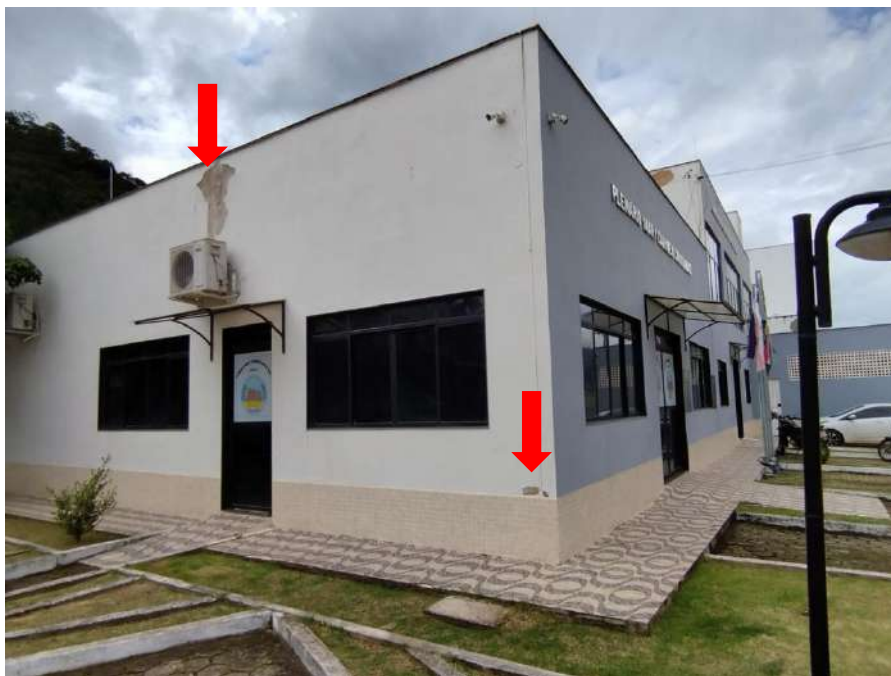
Figura 03 – Destaque para as paredes soltando a camada de proteção (pintura)
