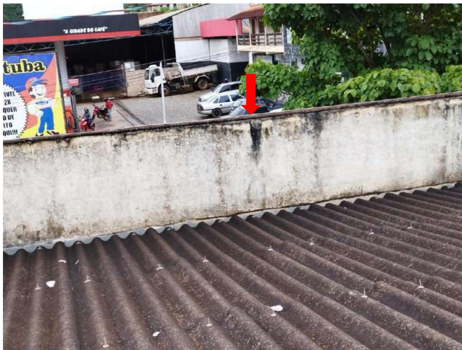
Figura 05 – Destaque para as paredes soltando a camada de proteção (pintura) e pintura com lodo, necessária de lixamento e recomposição da camada protetora
