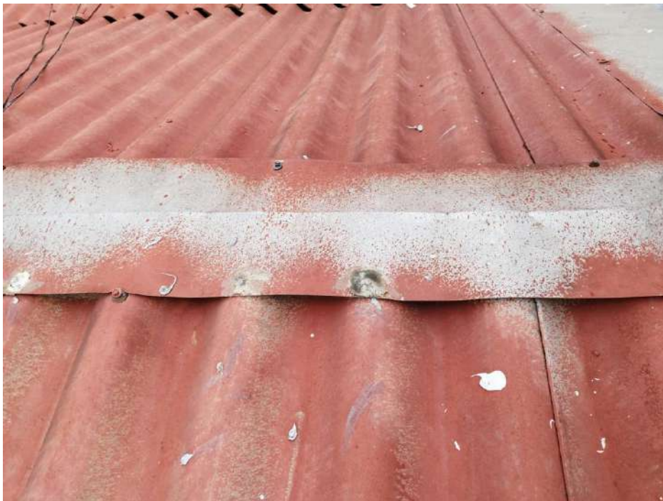
Figura 28 – Destaque para telhado do pavimento superior sem cumeeira e utilizando de chapa metálica mal executada.
