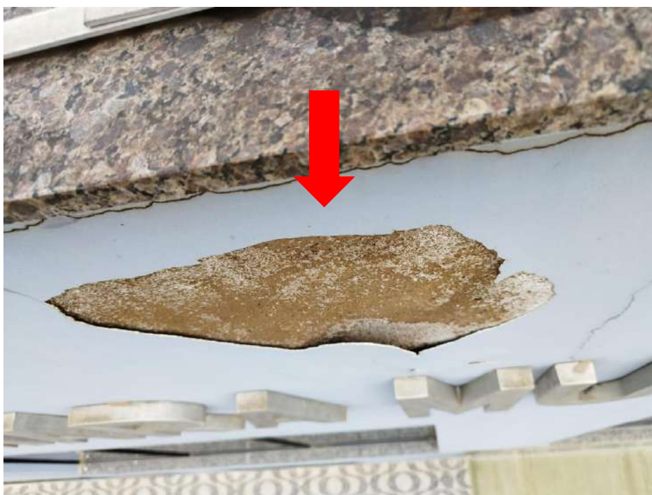
Figura 06 – Destaque para a parede da fachada frontal soltando a camada de proteção (pintura)
