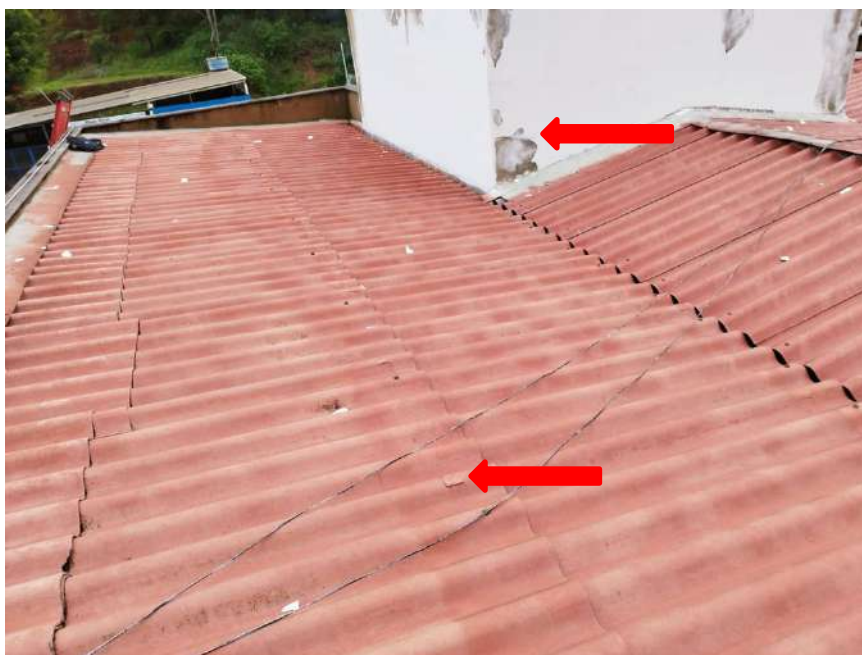
Figura 15 – Destaque para o telhado do pavimento superior com as telhas quebradas e trincadas, além da pintura das paredes da platibanda sem pintura e parede do reservatório com a pintura se soltando.
