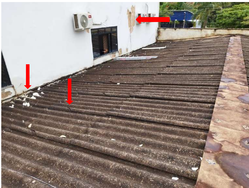
Figura 12 – Destaque para o telhado do plenário com as telhas quebradas e trincadas, além de calhas e rufos em estágio final de utilização. Paredes soltando a pintura.
