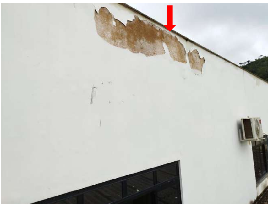
Figura 08 – Destaque para as paredes do pavimento superior soltando a camada de proteção (pintura)
