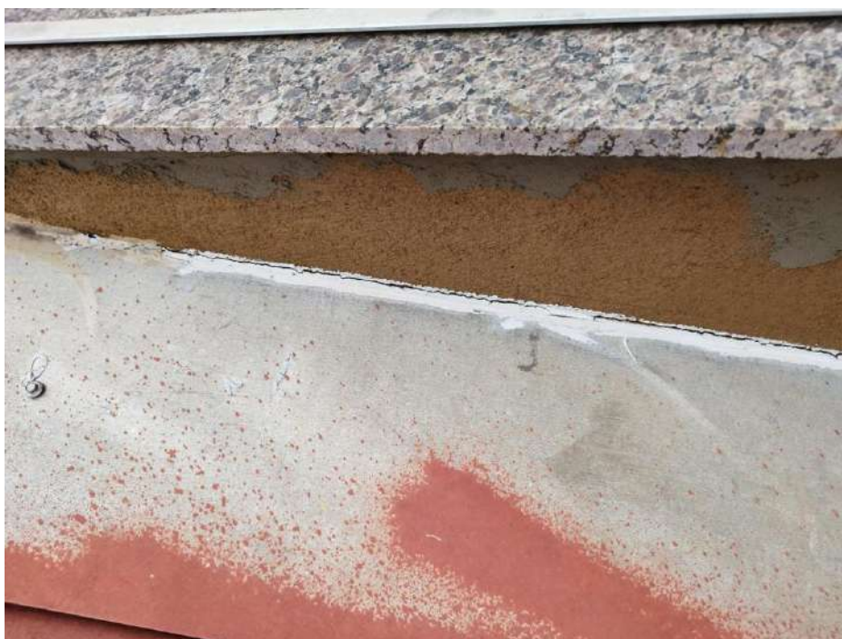
Figura 31 – Destaque para o rufo do telhado do pavimento superior mal soltando da parede. da platibanda sem pintura.
