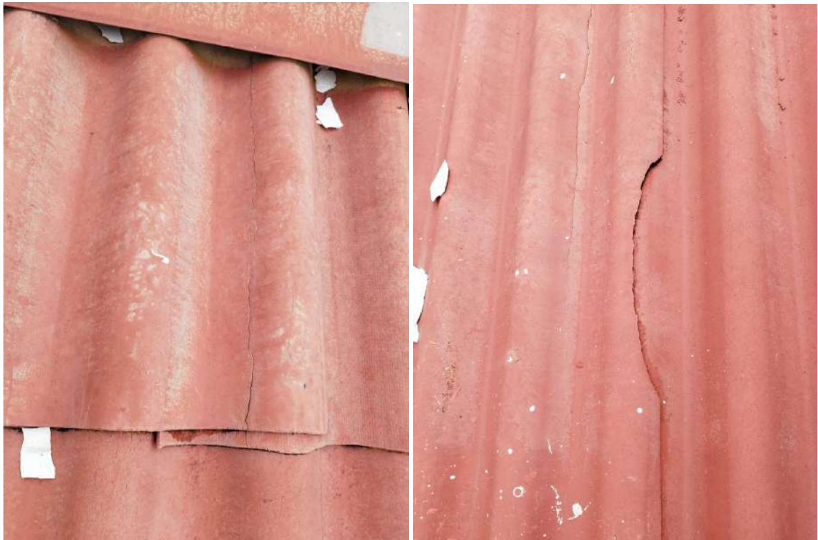
Figura 20 e 21 – Destaque para o telhado do pavimento superior com as telhas quebradas e trincadas.
