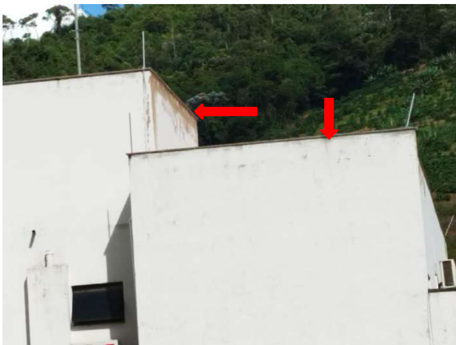
Figura 04 – Destaque para as paredes soltando a camada de proteção (pintura)
