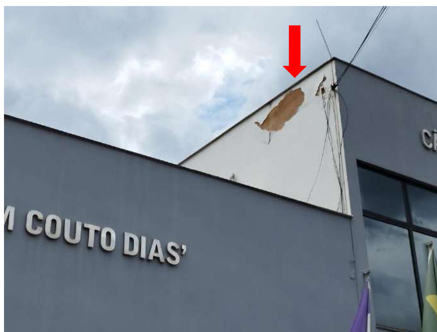
Figura 02 – Destaque para as paredes soltando a camada de proteção (pintura)
