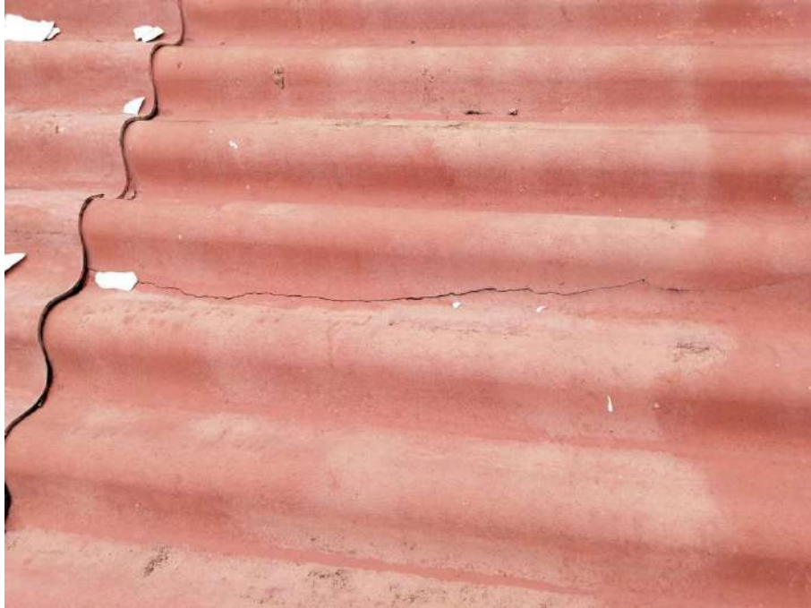
Figura 22 – Destaque para o telhado do pavimento superior com as telhas trincadas.
