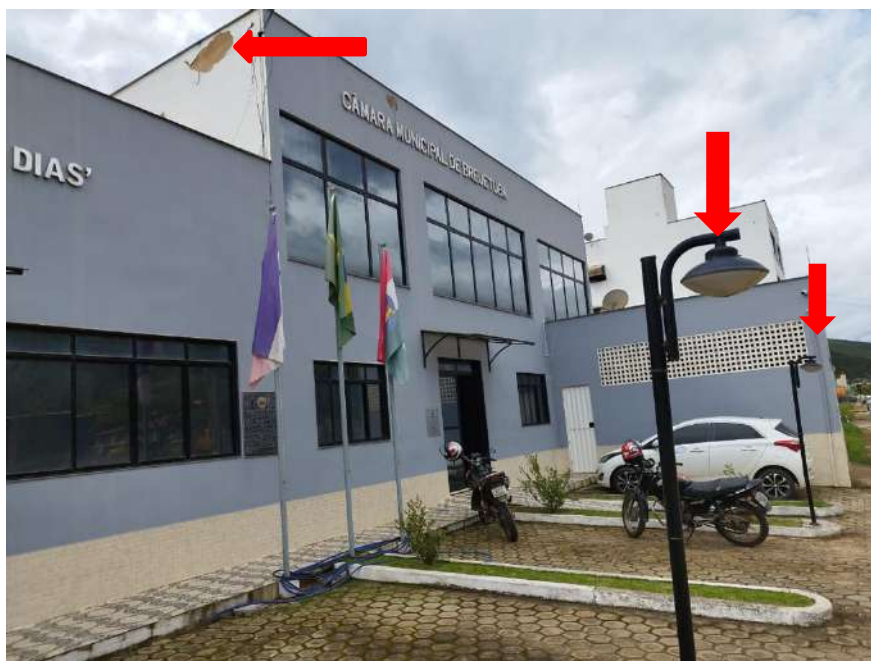
Figura 01 – Destaque para as luminárias que precisam ser substituídas e paredes soltando a camada de proteção (pintura)
