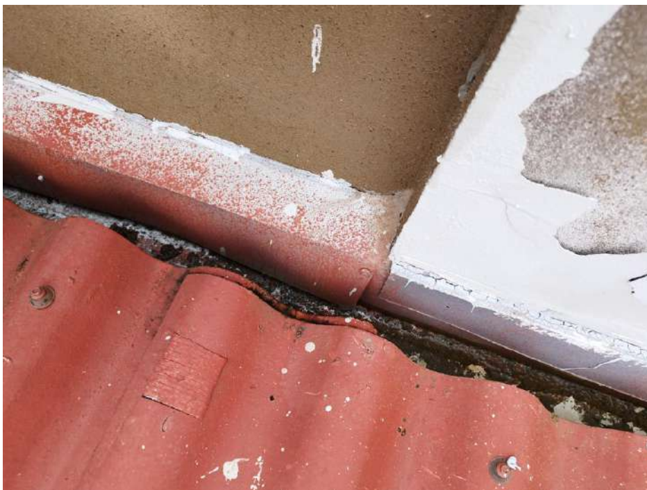
Figura 30 – Destaque para o rufo do telhado do pavimento superior mal encaixado da parede e sem traspasse. Parede da platibanda sem pintura e calhas com ausência de inclinação.
