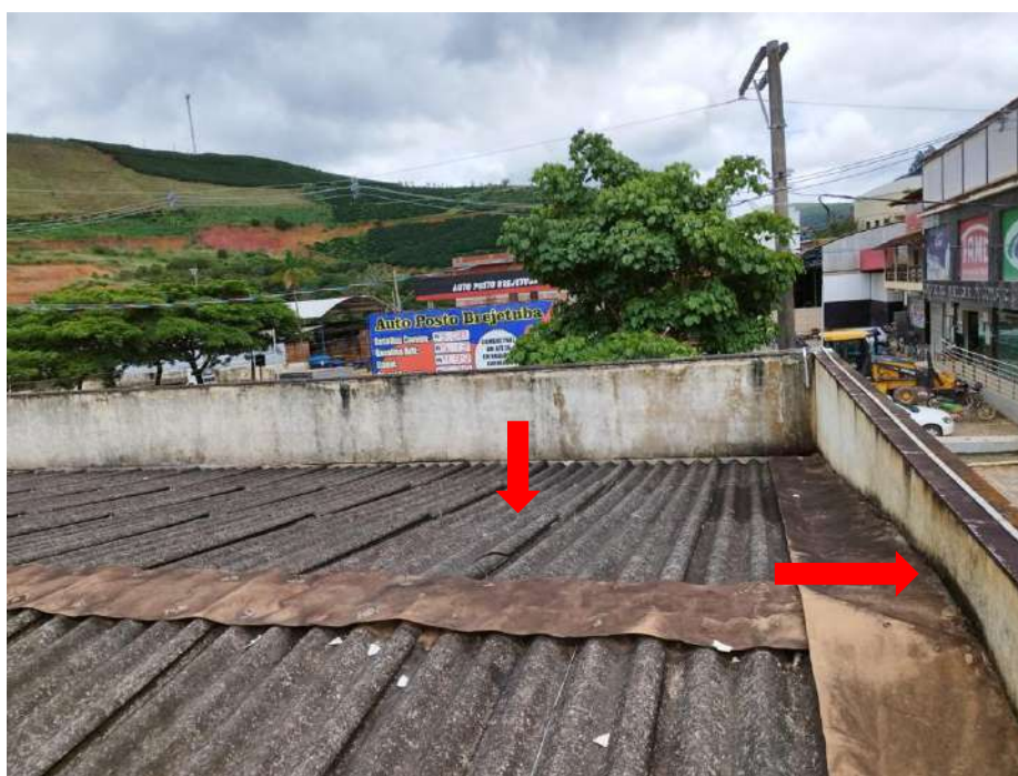
Figura 10 – Destaque para o telhado do plenário com as telhas e rufos em estágio final de utilização, causando patologias a edificação.
